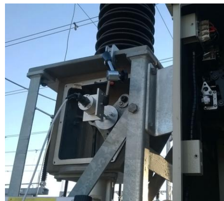
Transductor giratorio digital montado en el interruptor ABB LTB 245 kV SF6
